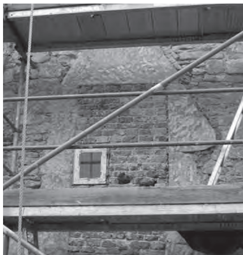
Baupuren im Außenmauerwerk
